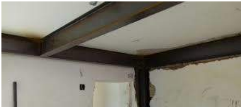
Figura 9-Reforço estrutural com viga metálica em obra de pub na regente feijó Tatuapé
