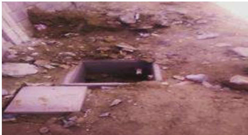
Figura 5: Abertura para a construção de caixas de esgoto sem proteção contra quedas no canteiro de obras
