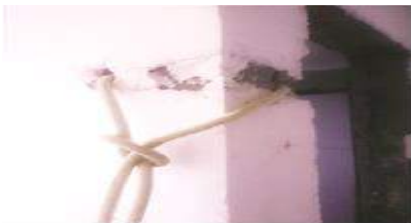
Figura 7: Falta de proteção contra desgaste do cabo de fibra sintética na instalação da linha de vida
