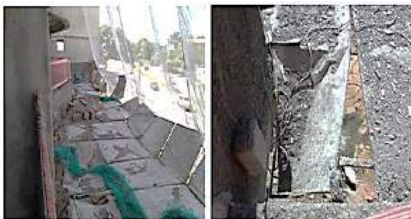
Figura 09: Falha na forração da plataforma de proteção primária
