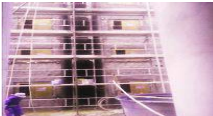
Figura 6: Andaime fachadeiro sem tela de proteção
