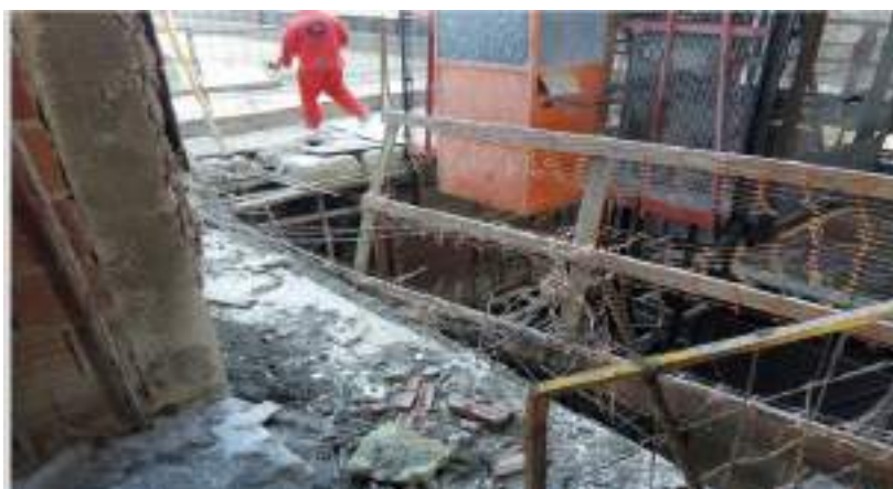
Figura 8: Falha na proteção contra quedas no 1º pavimento da edificação
