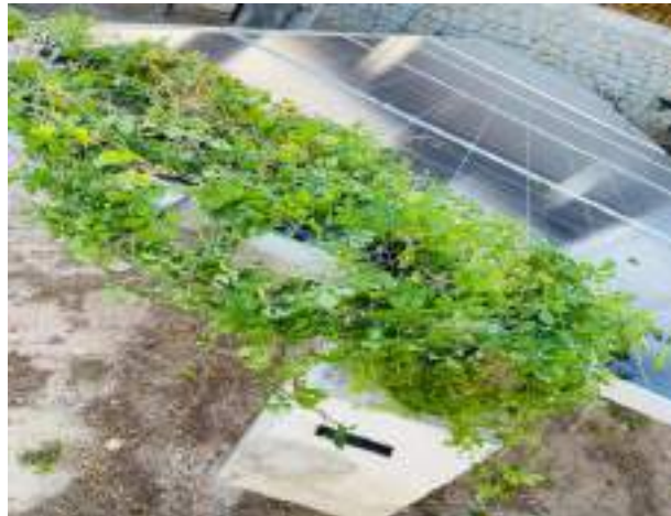
Figura 16 - Placa sem manutenção.
