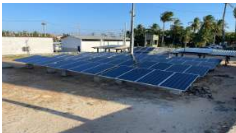
Figura 8 – Estação dos Painéis
