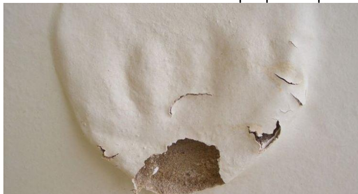
Figura 5 - Vesícula: bolha ocasionada por pintura prematura.
