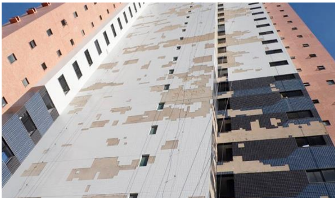
Figura 1 - Deslocamento de placas de cerâmicas em fachada de prédio
