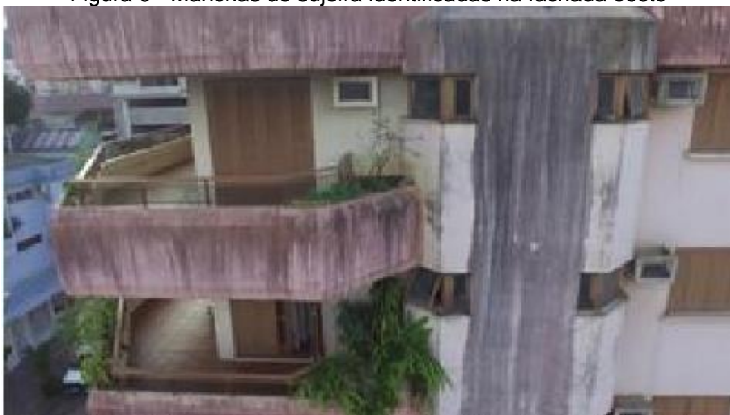
Figura 6 - Manchas de sujeira identificadas na fachada oeste
