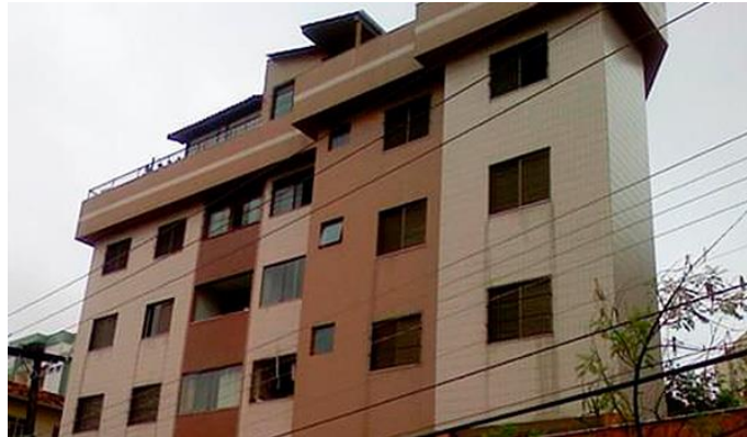
Figura 4 - Manchamento das placas cerâmicas
