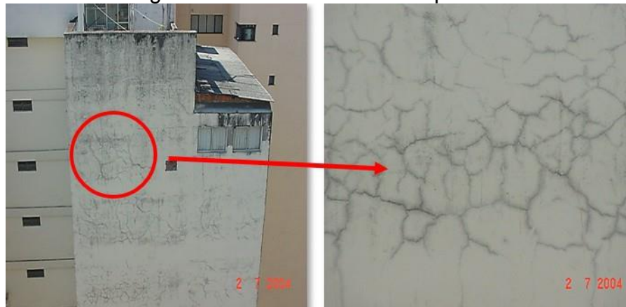
Figura 3 - Fissuras em uma superfície
