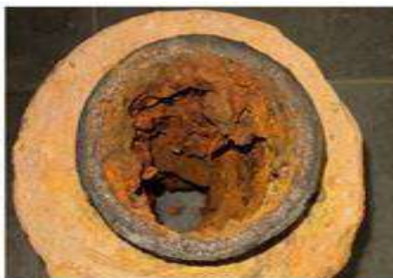
Figura 4 – Tubulação instalada em 1963 obstruída por oxidação.
