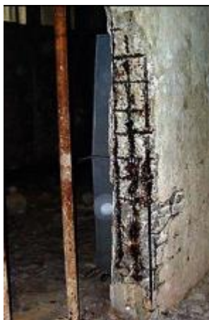
Figura 01: Pilar com armadura exposta
