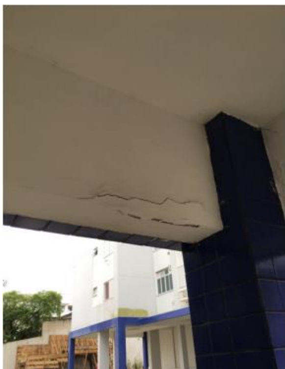
Figura 05: Deslocamento da viga
