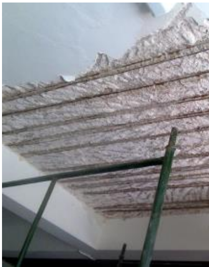
Figura 07: Desplacamento da laje
