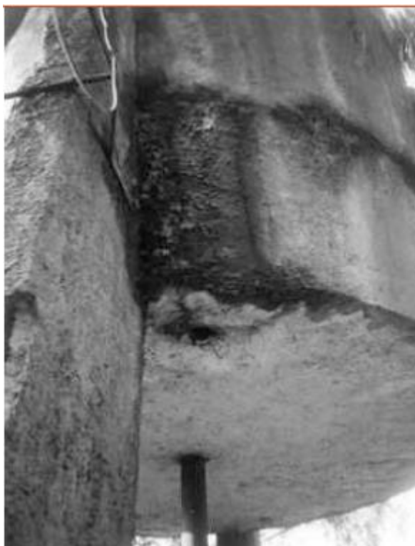
Figura 08: deterioração da laje de fundo e paredes do reservatório
