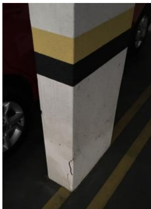
Figura 06: Trinca na linha da armadura devido à corrosão
