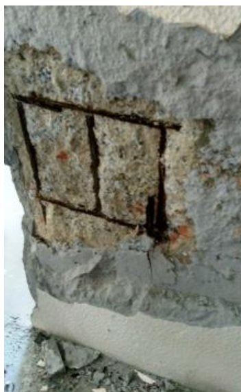
Figura 12: Corte para localização das armaduras corroídas
