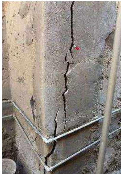
Figura 11 - Pilar com fissuras causadas por expansão devido corrosão das armaduras.
