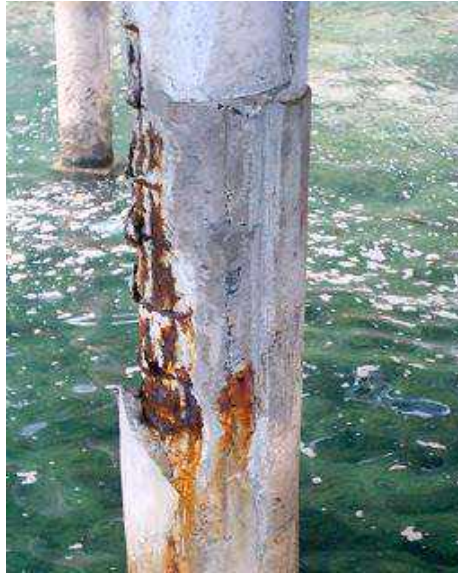
Figura 12 - Pilar degradado por ataque de cloretos.
