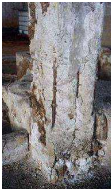
Figura 13 - Pilar degradado pela ação de sulfatos.
