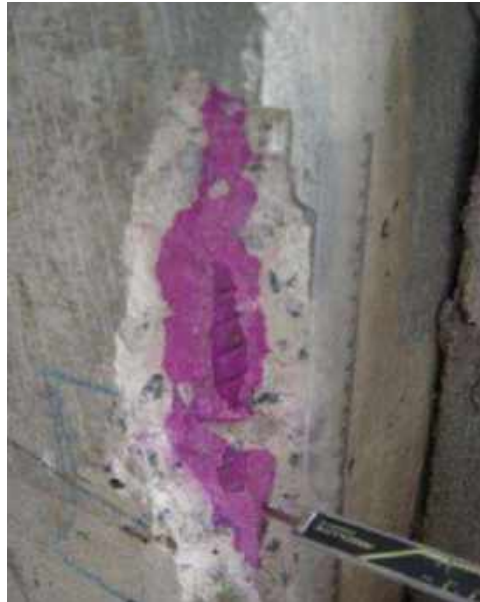
Figura 9 - Pilar com camada externa carbonatada.
