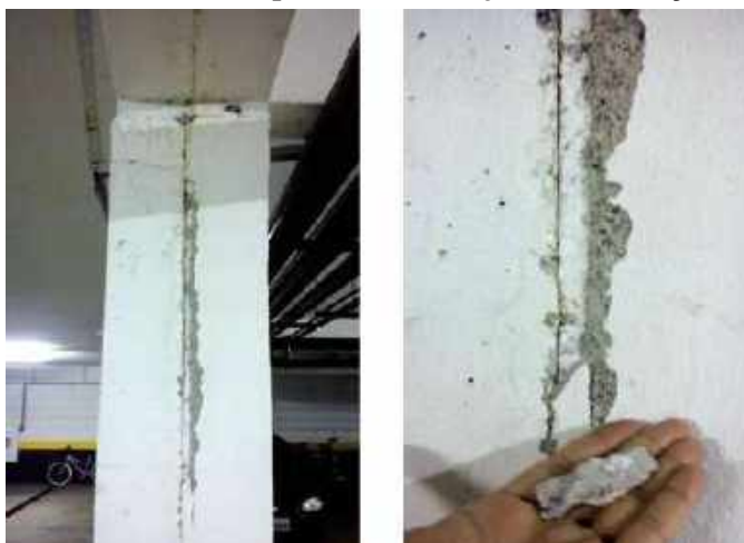
Figura 7 - Fissura causada pela ausência de junta de dilatação em pilar.
