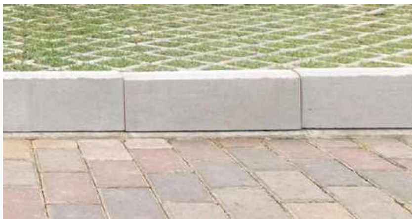
Figura 4 – Meio-Fio de concreto pré-moldado
