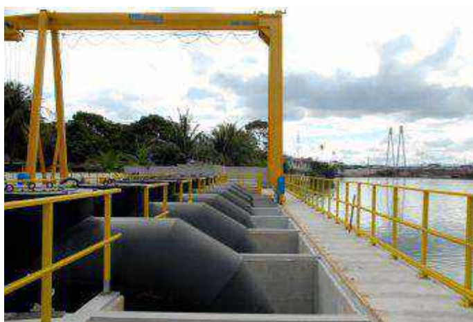
Figura 7 – Estação de bombeamento em Vitória, no Espírito Santo
