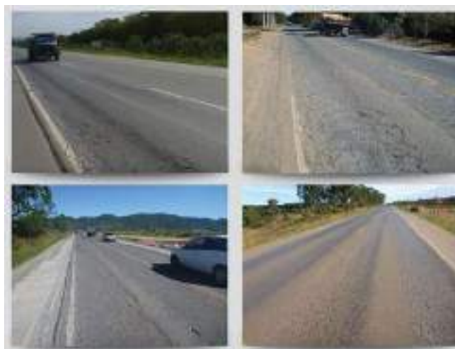
Figura 22 – Afundamento de consolidação
