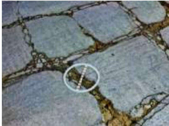
Figura 20 - Trinca interligada tipo bloco
