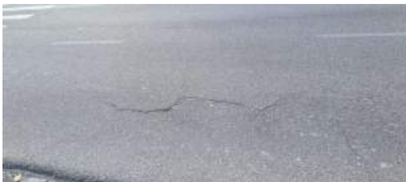
Figura 42 - Levantamento dos Defeitos, Fissuras
