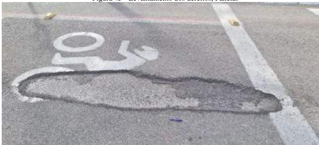
Figura 45 - Levantamento dos defeitos, Painelas
