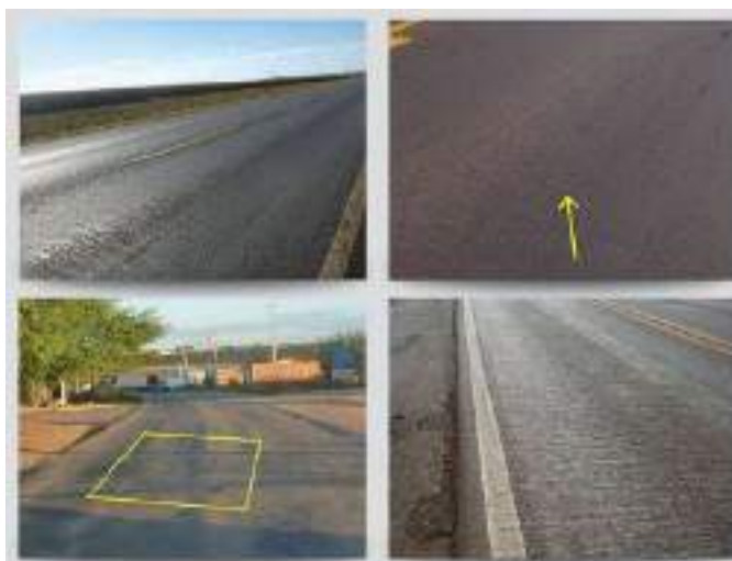
Figura 23 – Corrugação ou Ondulação
