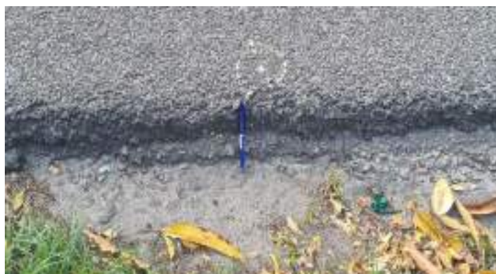
Figura 43 - Levantamento dos Defeitos, Escorregamento
