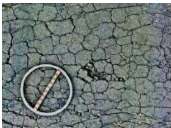
Figura 19 - Trinca interligada tipo jacaré
