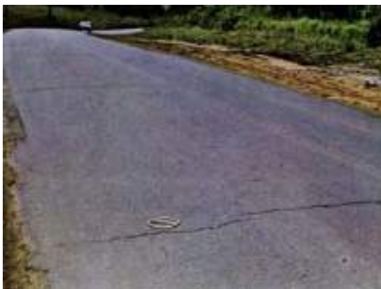
Figura 17 - Trinca isolada transversal
