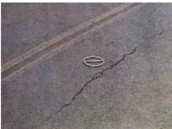
Figura 18 - Trinca isolada longitudinal
