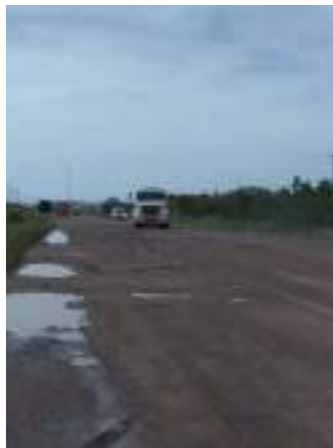
Figura 3 - Trecho rodovia CE-422 em 22/05/2019 - São Gonçalo do Amarante, CE
