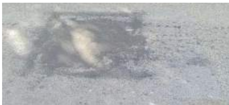
Figura 44 - Levantamento dos Defeitos, Remendos
