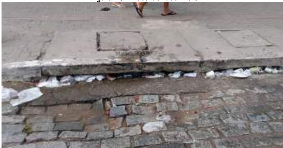
Figura 18 - Boca de lobo 4 e 5
