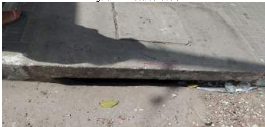
Figura 17 - Boca de lobo 3
