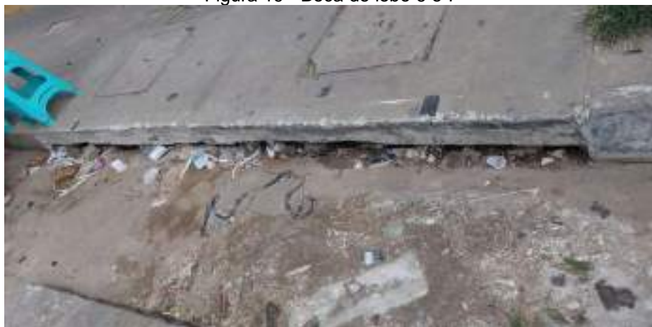
Figura 19 - Boca de lobo 6 e 7
