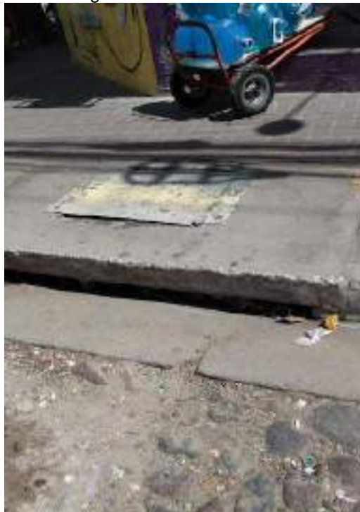
Figura 15 - Boca de lobo 1
