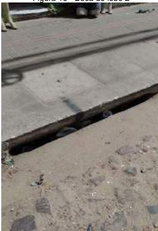
Figura 16 - Boca de lobo 2
