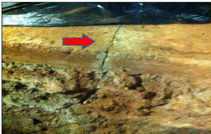
Figura 6 – Fissura em bloco de fundação decorrente de calor de hidratação.
