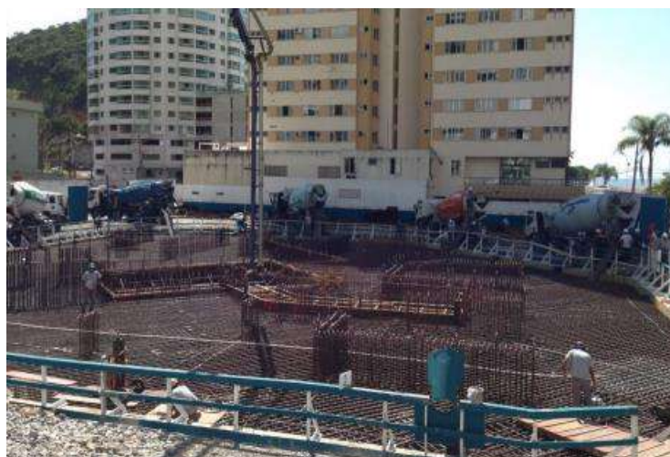
Figura 4 – Concretagem do bloco de coroamento do empreendimento Infinity Coast em Balneário Camboriú no ano de 2014.
