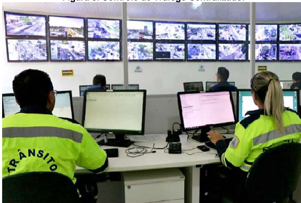
Figura 3. Controle de Tráfego Centralizado.
