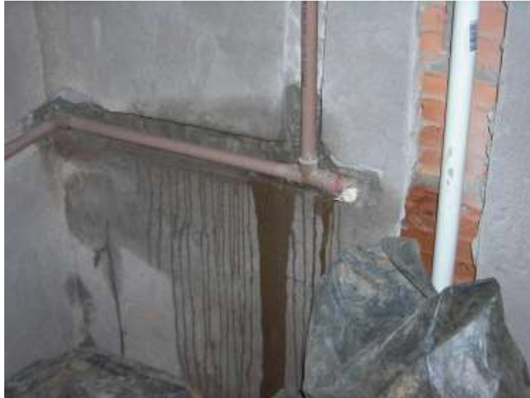
Figura 4 – Infiltração por vazamentos em redes hidráulicas
