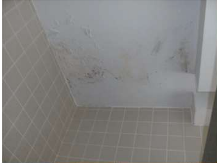
Figura 5 – Infiltração por condensação
